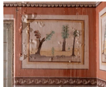
Figura 3. Área afectada notablemente por la humedad directa contrastando notablemente con el resto de los paramentos pintados.
